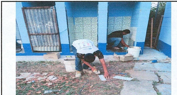
Foto1: Mejoramiento de servicio sanitario, colocación de azulejo, renovación de pintura en puertas y cambio de techo.
